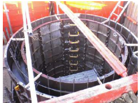
雨水幹線、汚水幹線、流域下水道、処理場、各種下水工事
