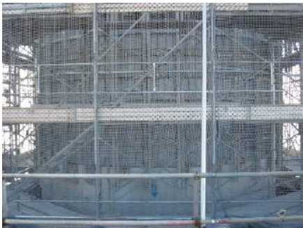
河川でのニューマチックケーソン、オープンケーソン工法 大型パネル化することで急速施工、省力化できます。
